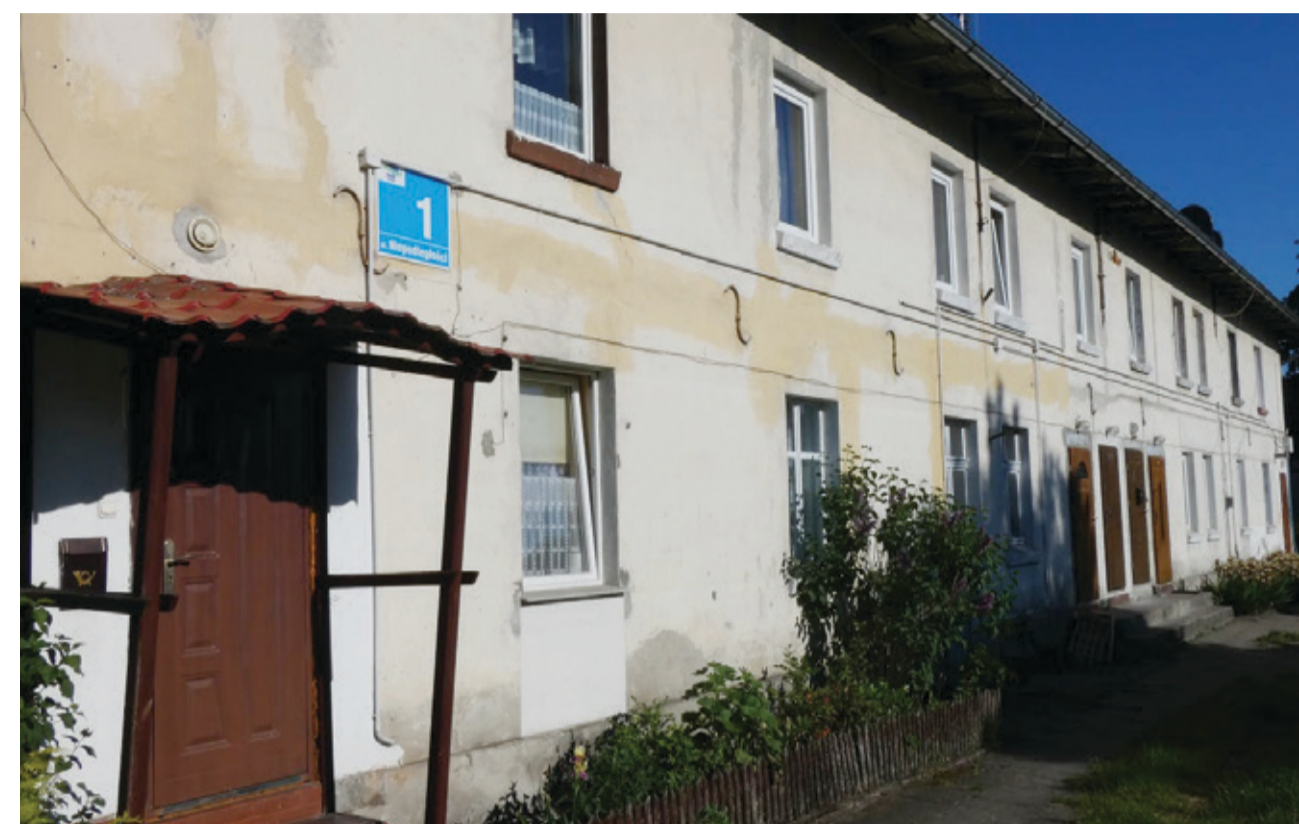
Obecny stan budynków wielorodzinnych przy ul. Niepodległości w Kępicach.
